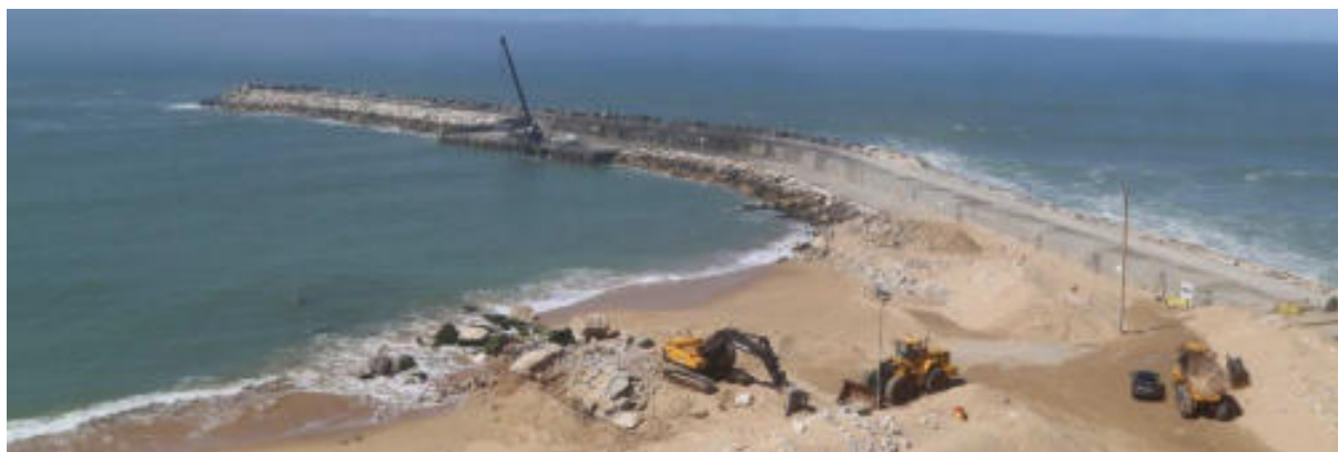
Figura 9.3 – Ericeira. Vista do molhe de proteção e da rampa varadouro (em obras)
