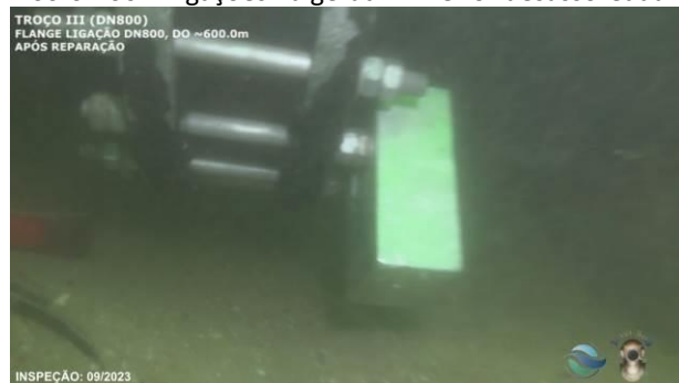
00-01-49 – Ligações e Ânodos lado Norte
