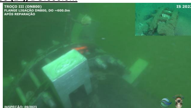
00-00-38 – Ligações e Ânodos no topo e lado Sul
